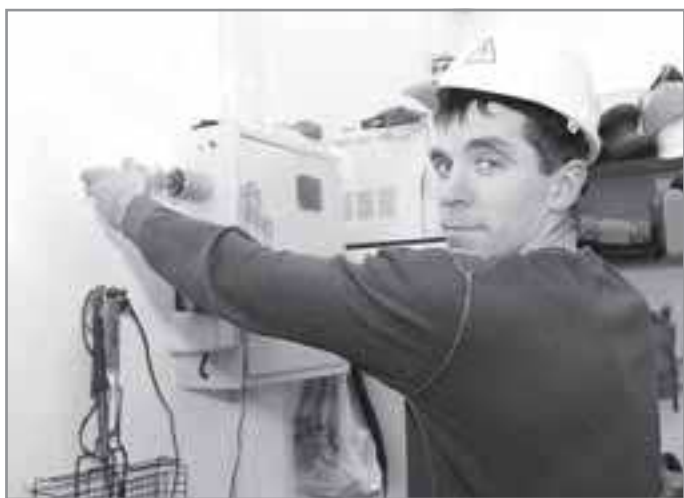
Павел Осипов - самый молодой электромонтер участка по обслуживанию и ремонту электрооборудования
