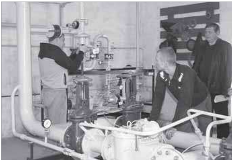
Бригада аварийно-диспетчерской службы проводит регулировку и настройку третьего газораспределительного пункта
