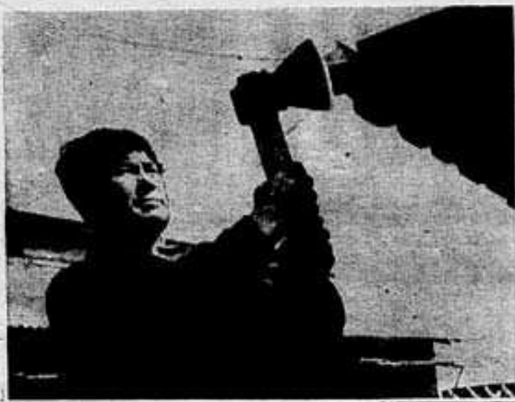
Хорошо потрудился на строительстве кирпичного завода в поселке Восыхово Шурышкарского района плотник Петр Николаевич Ребас. Выполняя сейчас, в основном, доделочные работы, он ежедневно перевыполняет производственные задания. НА СНИМКЕ: плотник П. Н. РЕБАСЬ. Фото И. Иванова.
