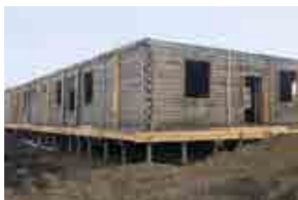
Вот так сейчас выглядит самый северный детский сад. От старого третьего корпуса «Северяночки» остались только стены. К августу здание будет не узнать
