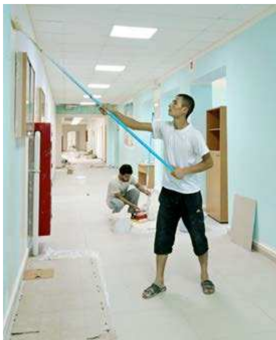
В здании начальной школы ТШИ ремонт сделан силами сотрудников тюменской фирмы ООО «Хорстам»
